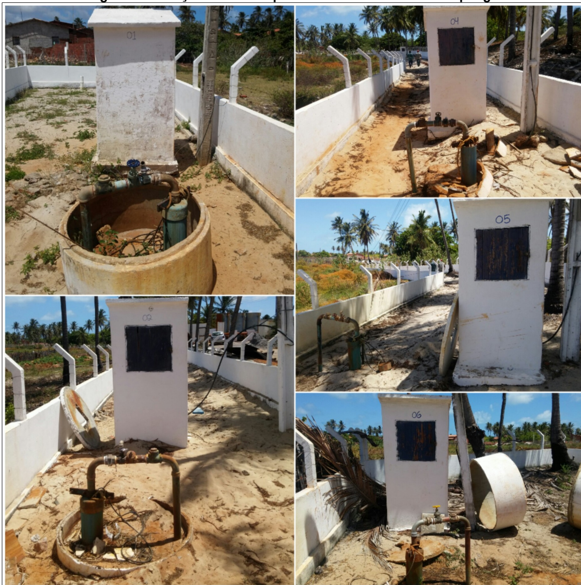
Figura 5.23: Poços tubulares que abastecem o distrito de Caponga.
