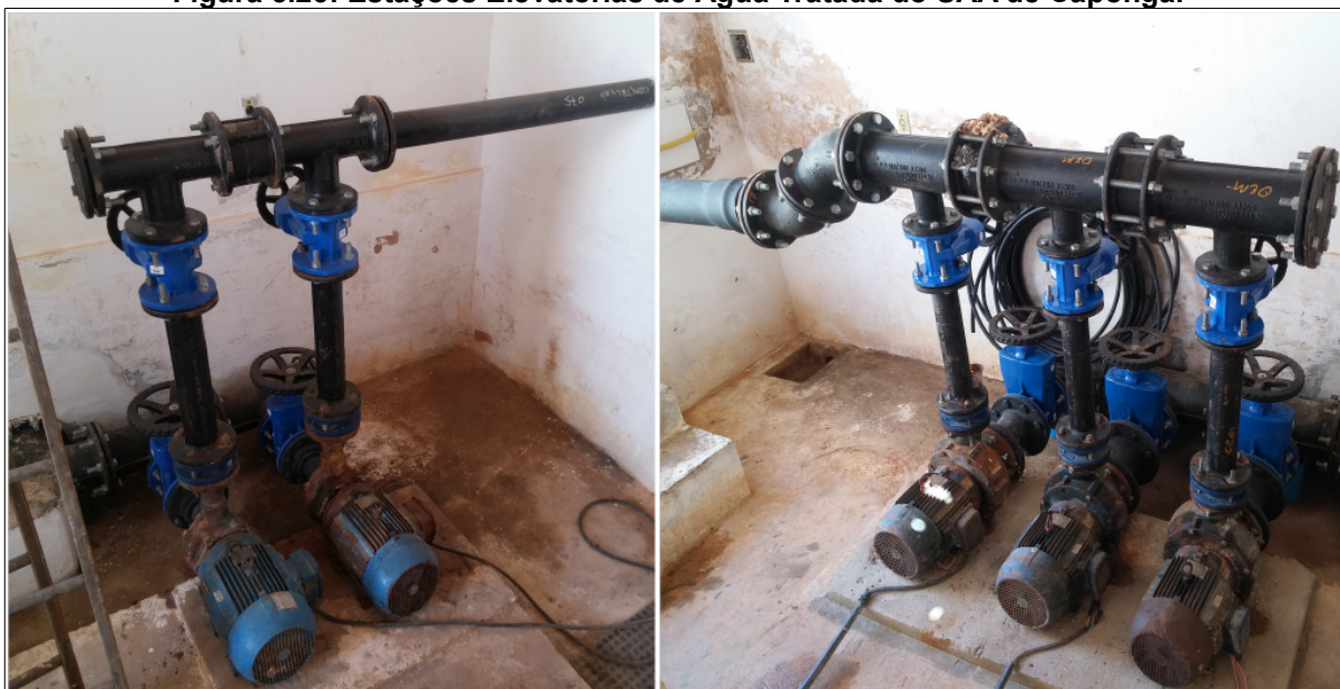
Figura 5.26: Estações Elevatórias de Água Tratada do SAA de Caponga.
