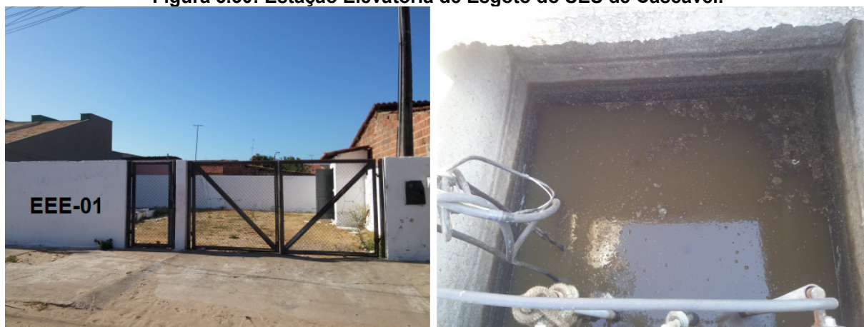
Figura 5.30: Estação Elevatória de Esgoto do SES de Cascavel.
