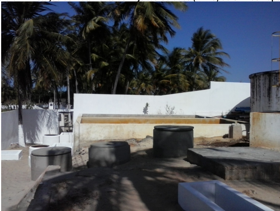
Figura 5.27: Estação de Tratamento de Rejeitos Gerados (ETRG) do SAA de Caponga.
