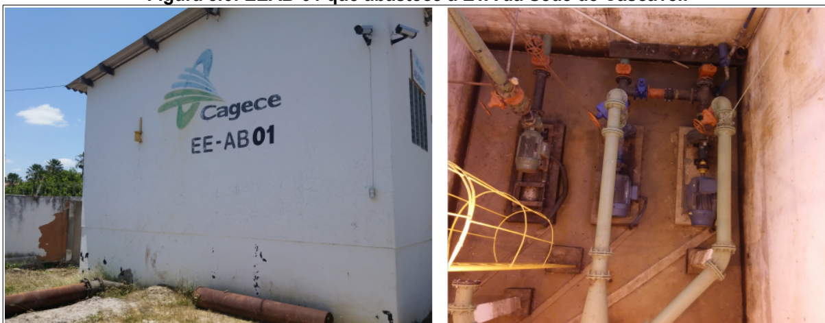
Figura 5.6: EEAB-01 que abastece a ETA da Sede de Cascavel.
