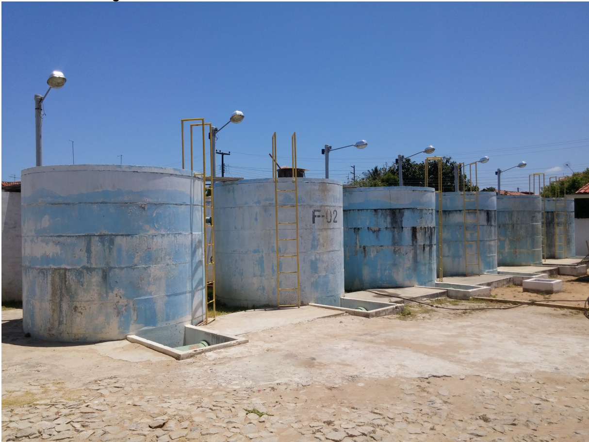
Figura 5.9: Filtros de tratamento utilizados na ETA de Cascavel.
