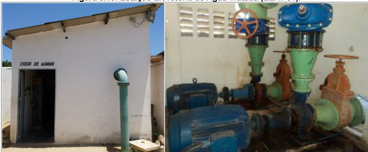
Figura 5.10: Estação Elevatória de Água Tratada (EEAT-01).
