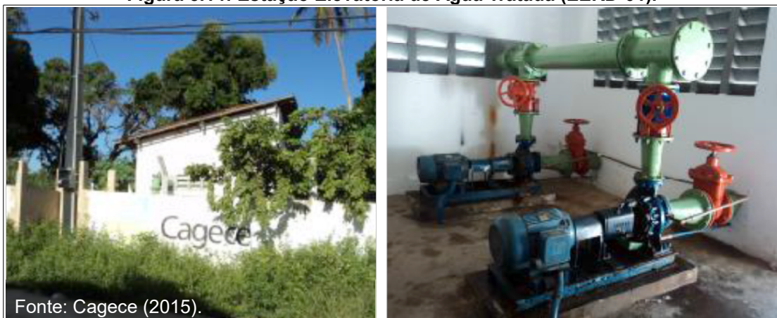
Figura 5.14: Estação Elevatória de Água Tratada (EERD-01).
