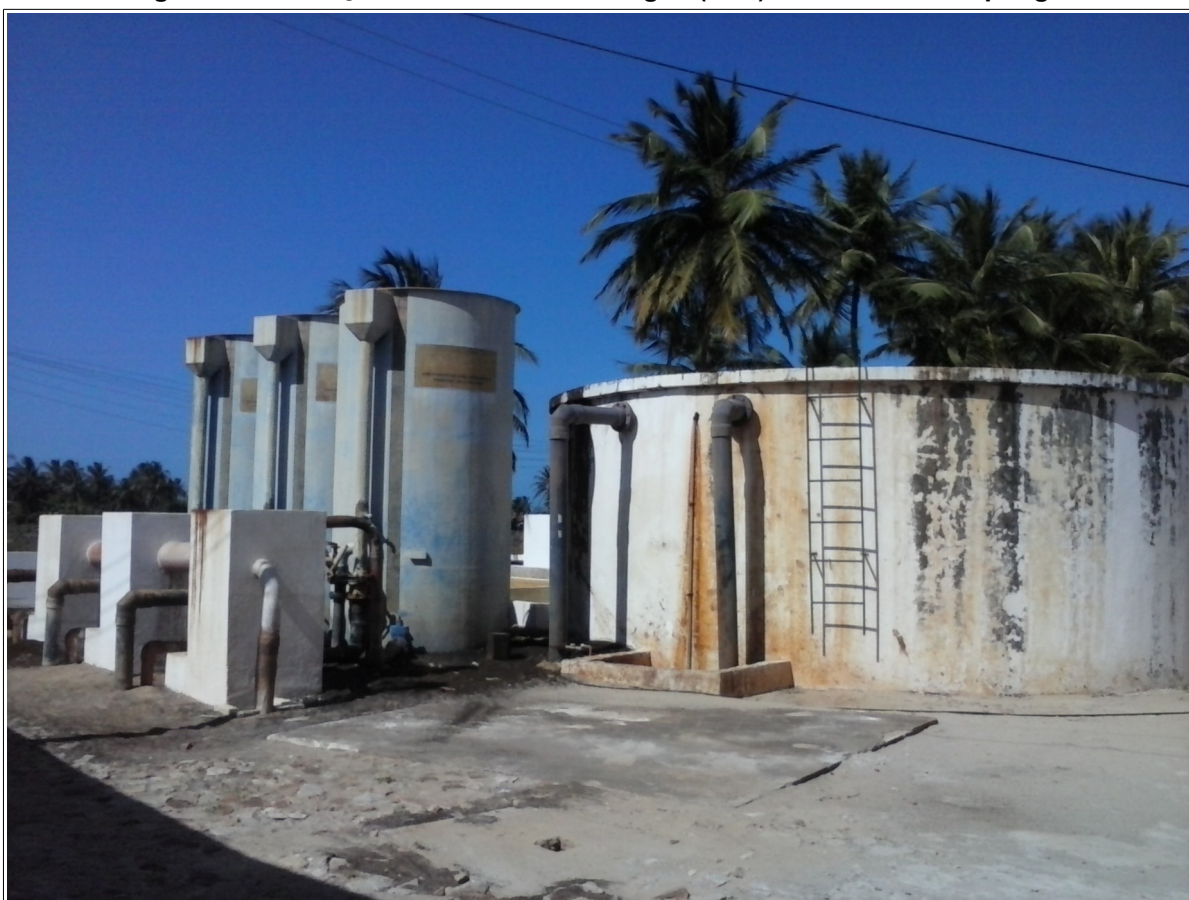
Figura 5.24: Estação de Tratamento de Água (ETA) do distrito de Caponga.
