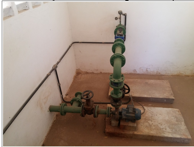
Figura 5.11: Estação Elevatória de Água Tratada (EEAT-02).
