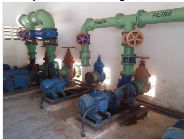
Figura 5.13: Estação Elevatória de Lavagem dos Filtros (EELF-01).
