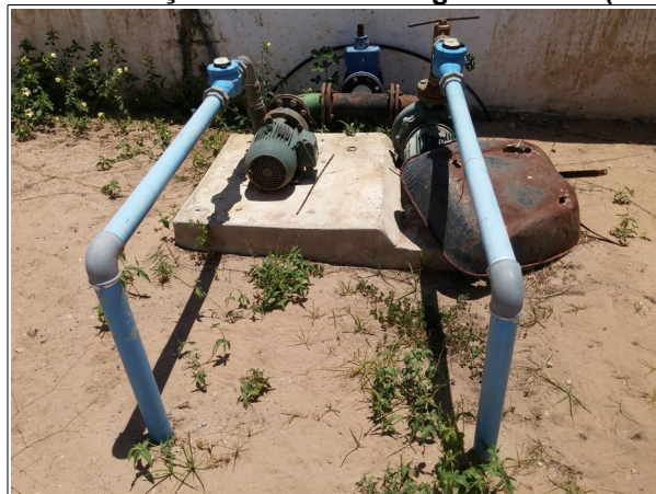
Figura 5.12: Estação Elevatória de Água Tratada (EEAT-03).
