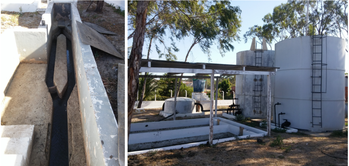
Figura 5.31: Estação de Tratamento de Esgoto (ETE) do SES de Cascavel.
